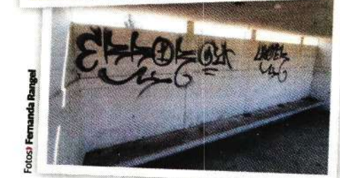
ARRIBA, suelo sin arcilla en la zona de la caja de bateo; abajo, un dugout vandalizado.
